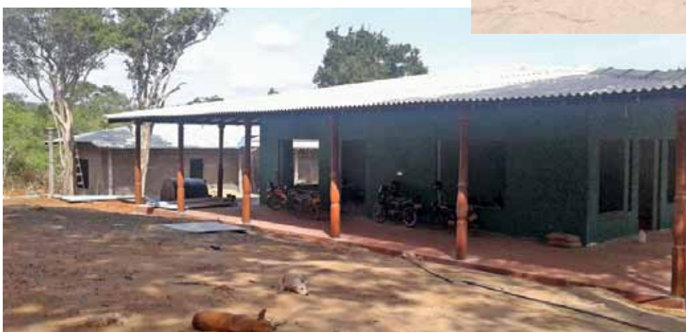
Het casco van het hoofdgebouw en het facilitaire gedeelte is gereed. Nu de afwerking binnen nog.
